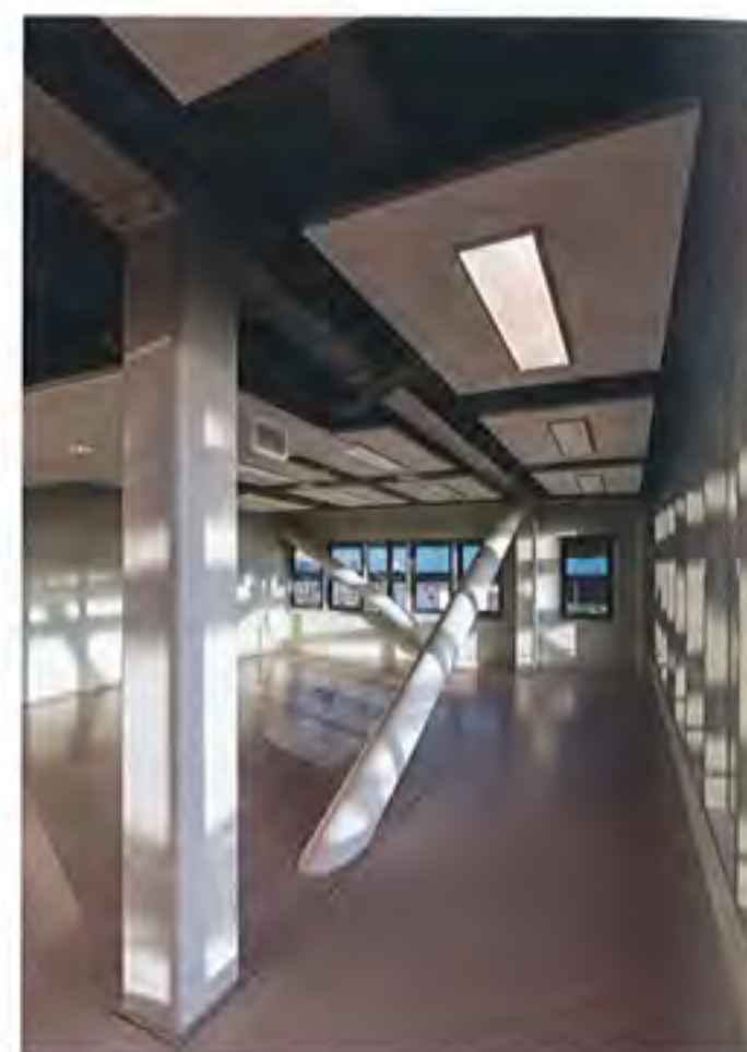
In verband met betonkernactivering zijn open plafonds toegepast.
